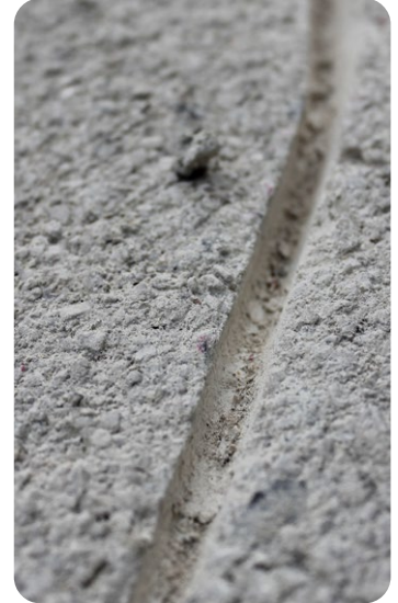
Limpiar polvo dentro de la grieta
